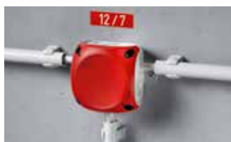
Pour éclairage de secours
